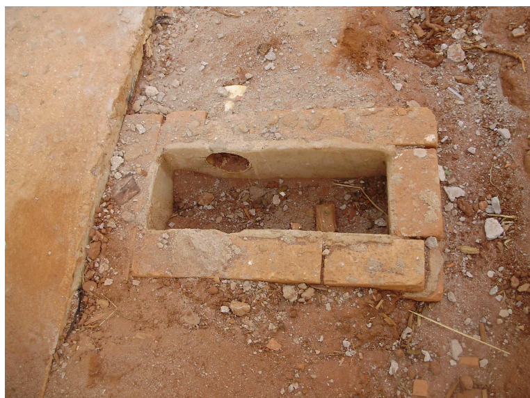
Foto 07: Esgotamento sanitário. Autor: AZEVEDO, 2010.
