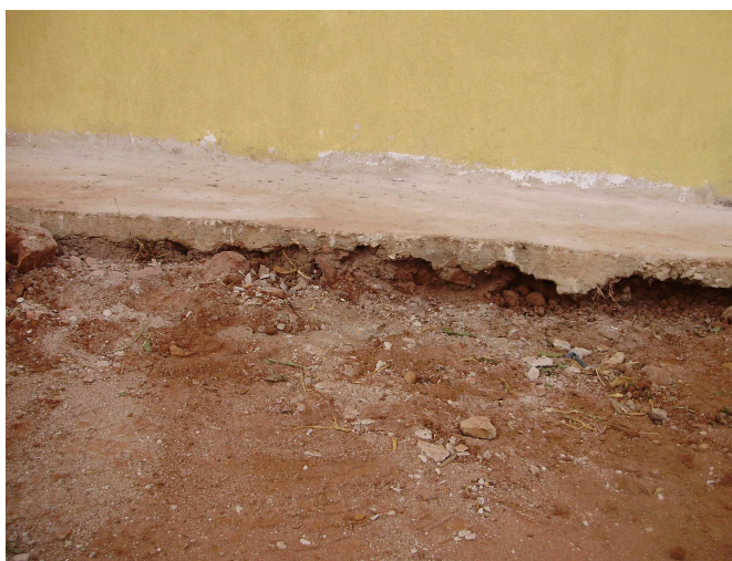
Foto 09: "Radie" mal construído. Autor: AZEVEDO, 2010.
