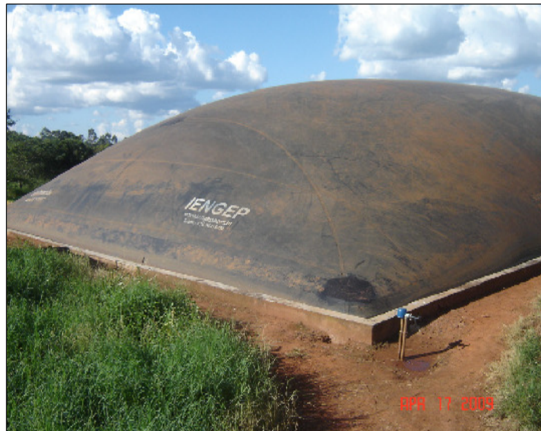
Foto 1 – Fazenda Nossa Senhora das Graças, Uberlândia (MG): Biodigestor Canadense
