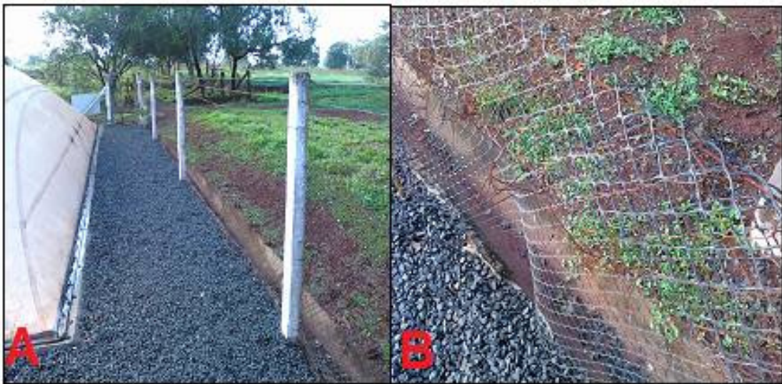
Foto 2 (A), 3 (B) - Oxidação das grades no entorno do Biodigestor – Uberlândia (MG),
