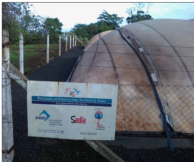
Foto 4 – Biodigestores da propriedade visitada – Uberlândia (MG)
